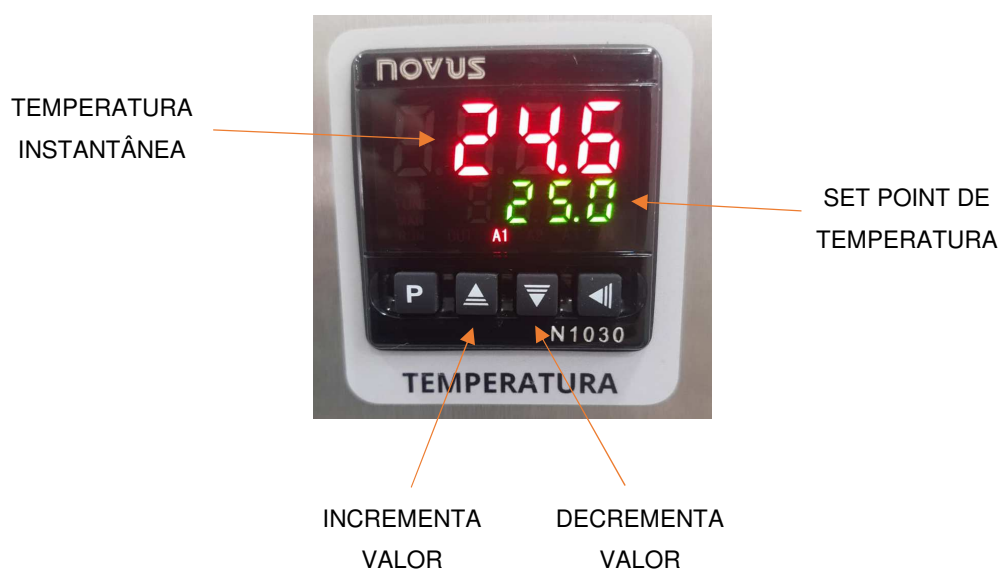
Figura 03 – Controlador de temperatura
